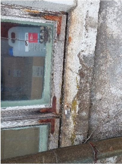
Esimerkki ikkunoiden tilanteesta. Puu on haurasta ja vaurioitunut kosteuden vaikutuksesta.
